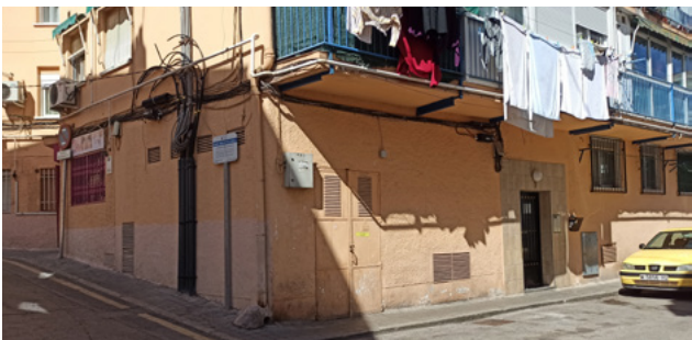
Cables y tubos en fachada
