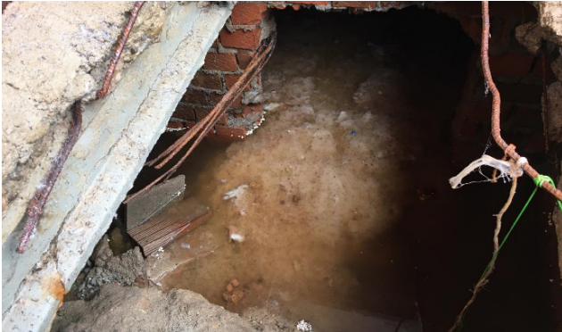
Cámara de aire inundada
