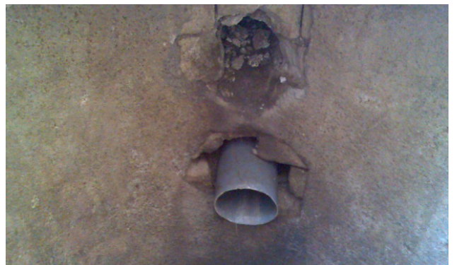
Conexión de tubería a pozo de registro sin perímetro sellado
