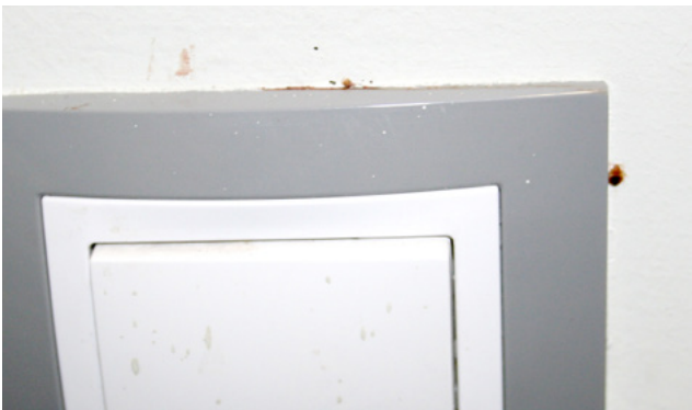
Chinches en interruptor
