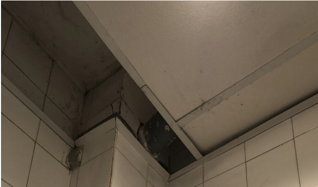
Conexión bajante sanitaria con falso techo
