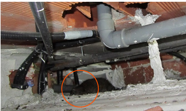
Cadáver de rata en doble techo, bajantes sin sellar
