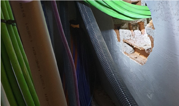
Interior de patinillo con deficiente conexión a armario exterior
