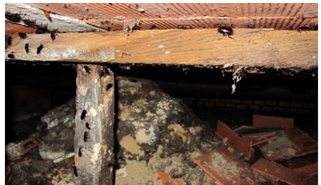
Presencia de cucaracha negra en cámara de aire
