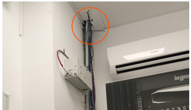
Conexión deficiente a armario RAC
