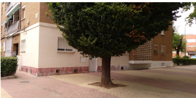
Respiraderos cámaras sanitarias
