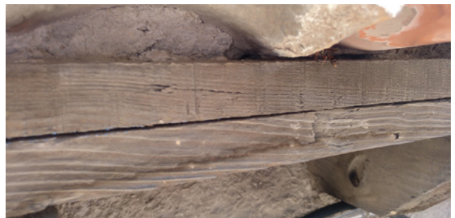
Sellado deficiente en cubierta
