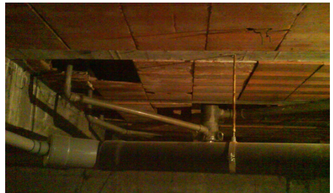
Conducciones sin sellar en su conexión con forjado
