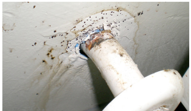
Pasatubo de radiador mal sellado
