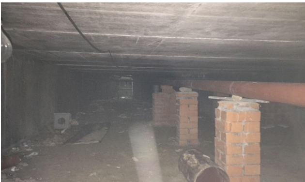
Presencia de escombros en cámara de aire
